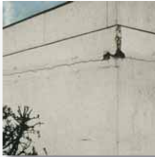
7 Microfissures et fissures
