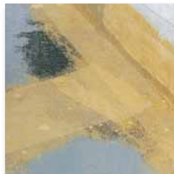
Traitement d'une fissure (entre 3/10 ème et 20/10 ème mm)
