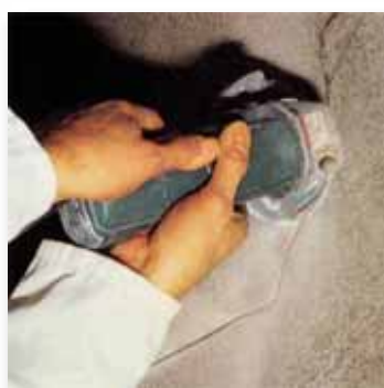
Ouverture au disque ou à la griffe des fissures > 0,8 mm localisées aux points singuliers.
