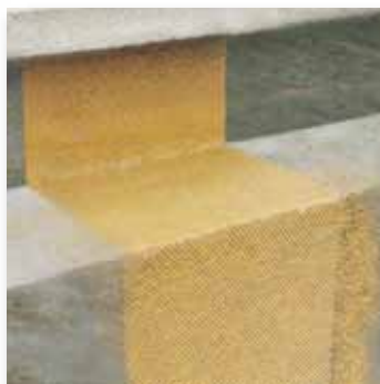
Pied de garde-corps et fissures en about de dalles
